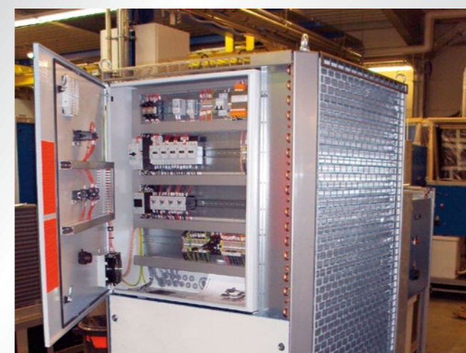
„Gut organisiert und bestens geregelt“: Blick in den Schaltschrank einer ONI Kompakt-Kältemaschine. „Dobra organizacja i doskonała regulacja“ - wewnątrz szafy sterowniczej kompaktowego agregatu chłodniczego ONI.
